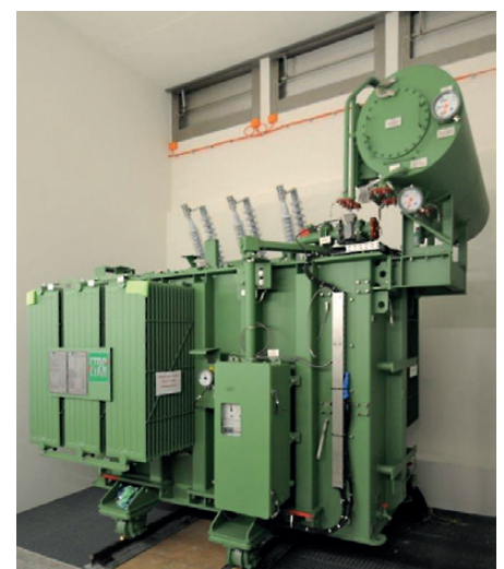
Der neue Transformator in Tramelan
