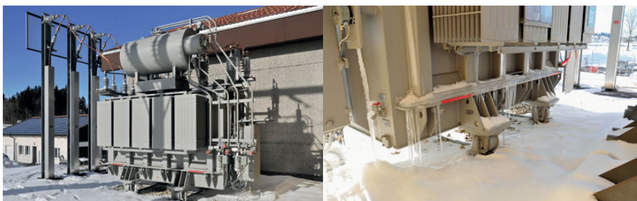
Der neue Transformator im winterlichen Le Noirmont
