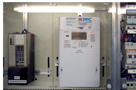
Compteur Elster AS3000 avec module passerelle BPL 4M intégré
