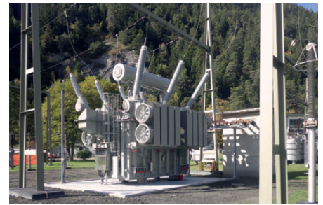
Le nouveau transformateur, vu depuis le raccordement principal 245 kV
