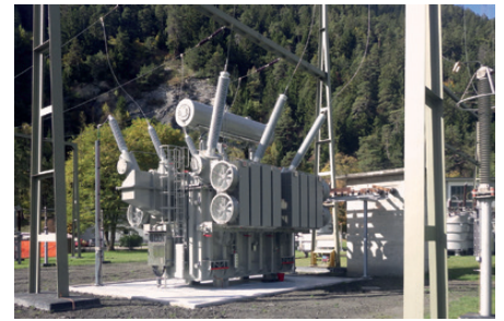
Der neue Transformator vom 245-kV-Hauptanschluss her gesehen
