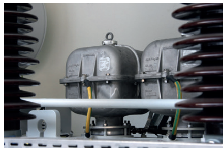
Les raccordements basse tension du transformateur sont réalisés avec des connecteurs enfichables de la société Pfisterer.
