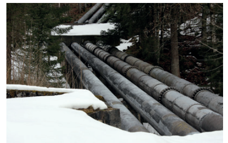
Les conduites sous pression posées il y a près de 100 ans présentent une pente de 312 m.
