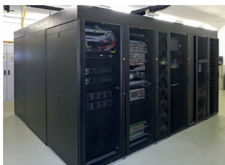
Baie de commande centrale RKS-870-PC et baie de commande de secours au centre informatique à Sarnen
