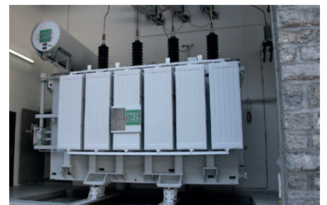
L'un des deux nouveaux transformateurs 15 MVA
