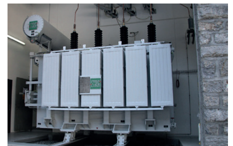
Einer der beiden neuen 15-MVA-Transformatoren
