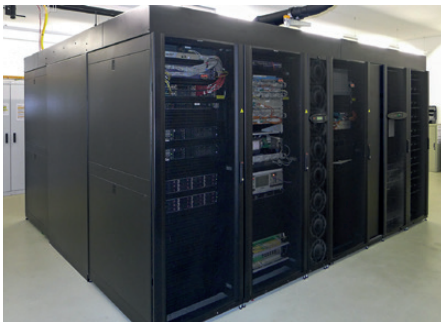
Zentraler RKS-870-PC sowie RKS-Notkommandogerät im Rechenzentrum in Sarnen
