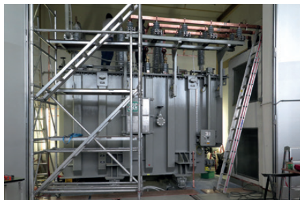
Le transformateur en position définitive
