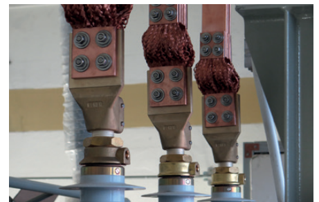
Les connexions en 6,3 kV avec des transitions flexibles entre les barres en cuivre et les connexions du transformateur
