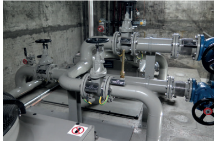
Les conduites d'huile au niveau des ventilateurs
