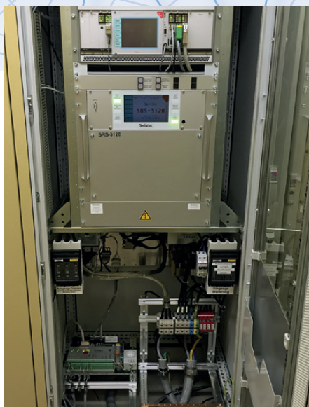
Émetteur de télécommande centralisée au poste Naters
