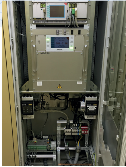
Rundsteuersender im UW Naters
